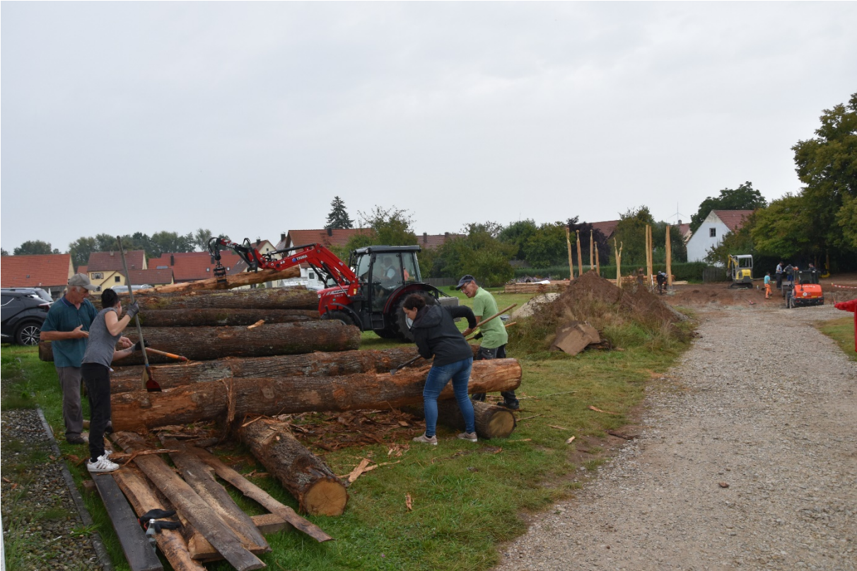
Am 3. Tag ging es los mit dem Schälen der Eichen, ebenso mit der Weiterarbeit an den Klettergeräten. Im Krippengarten stehen bereits die Balken für die beiden Bauschaukeln
